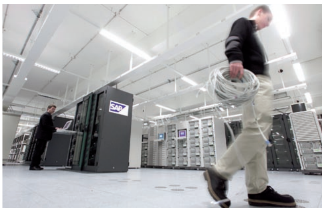
Konsolidierung im Rechenzentrum: Durch den Einsatz von Citrix XenServer benötigt die SAP künftig 70 Prozent weniger Server für ihre XenApp-Umgebung.
